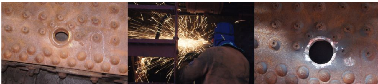
Ausbrennen einer Waschlukn an der Stehkessel - vorher und nachher
